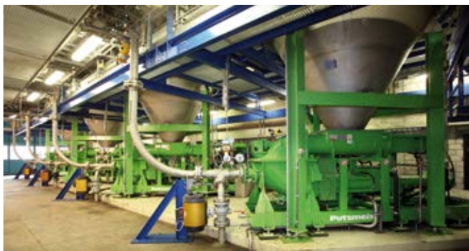
Bomba KOS 1050 na planta de tratamento de esgoto ProRheno (Basel, Suíça)
