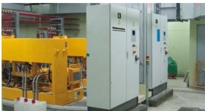
Painel de controle na estação de tratamento de águas residuais de Gulpocheon (Coreia do Sul)
