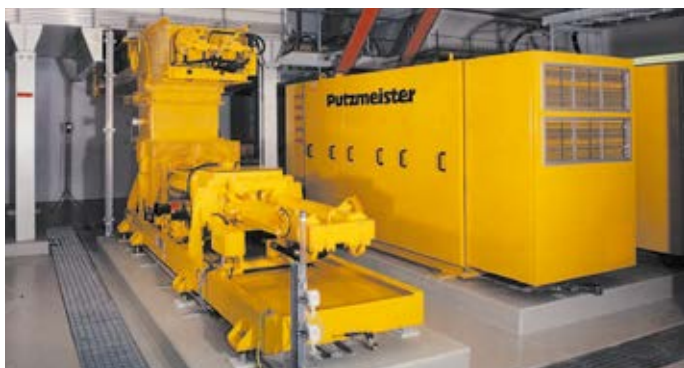
Co-incineração de lamas de depuração em estação de energia alimentada por carvão – Zolling (Alemanha): KOS 2180
