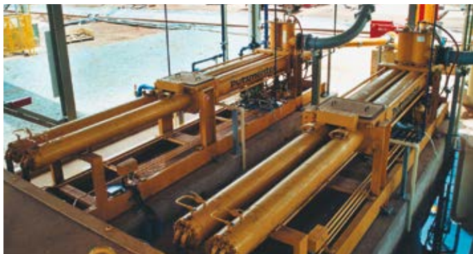
Duas bombas de rejeito HSP 25100 na mina de ouro de Bulyanhulu (Tanzania)
